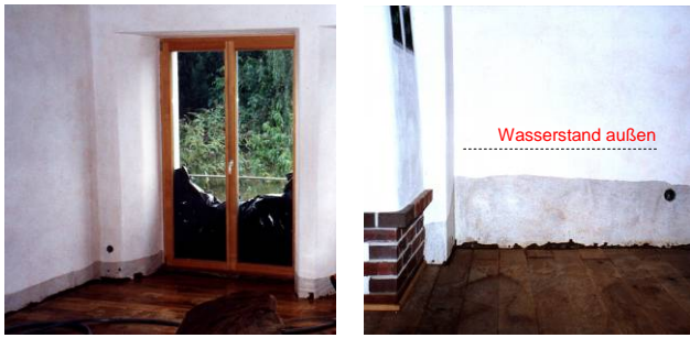
Bild 3 (li): Trotz außen anstehendem Wasserspiegel von ca. 50 cm über OFFB (Oberfläche Fertigfußboden), war im Innenbereich nach 3 Tagen der Lehmputz nur bis ca. 15 cm über OFFB durchfeuchtet.
